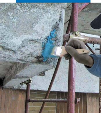
Application au pinceau de Mapefer 1K sur des armatures de balcon en béton armé
